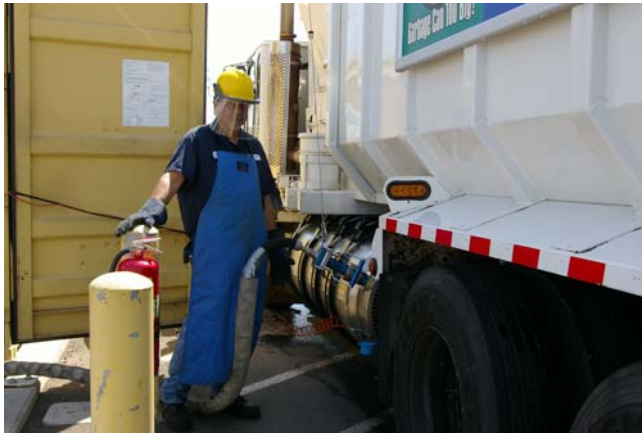
LNG Fueling Facility
